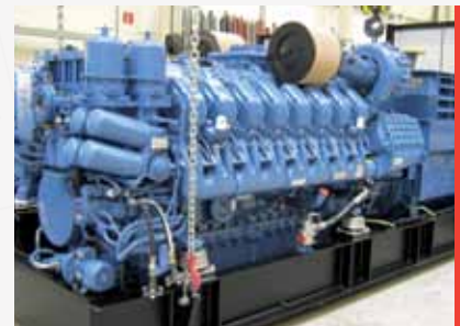
▲ DBR Offshore DGS 2250 kVA
